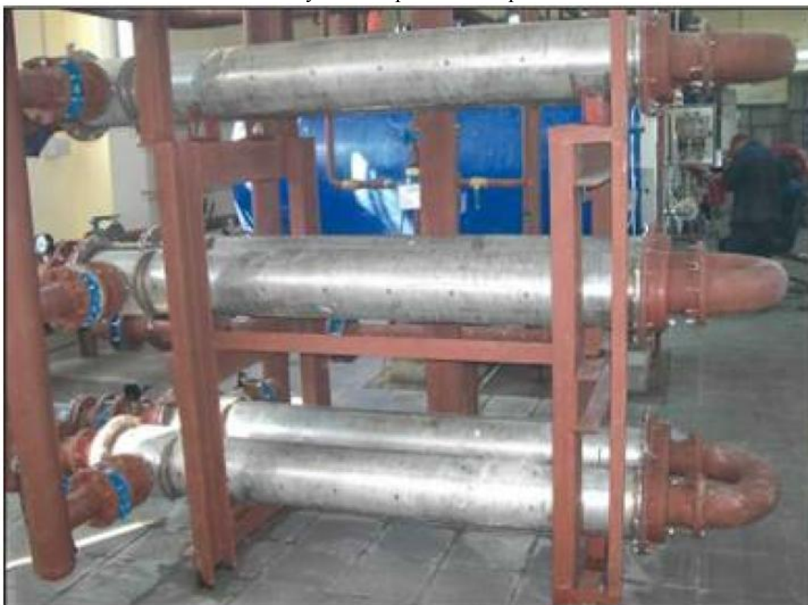
Рисунок 8 - Теплообменники ВВПИ в котельной МУП «Теплосервис»
