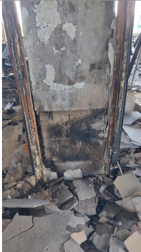
Фотография 22 – Повреждение защитного слоя бетона ж/б колонны в результате термического воздействия на 4 этаже здания в осях Б/4
