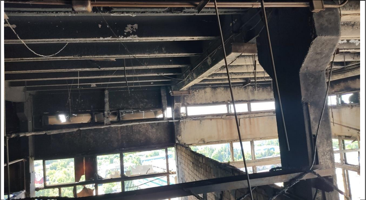
Фотография 9 – Повреждения ж/б плит перекрытий, колонн и балок в результате термического воздействия на 9 этаже здания в осях А-Б/2-3
