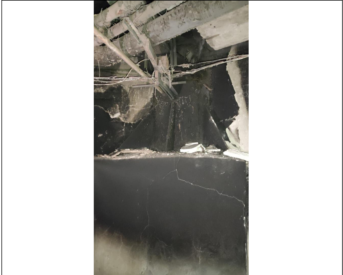
Фотография 33 – Повреждение металлической колонны и защитного слоя бетона фундамента в результате термического воздействия на конструкции в подвальном помещении здания в осях Б/8-9
