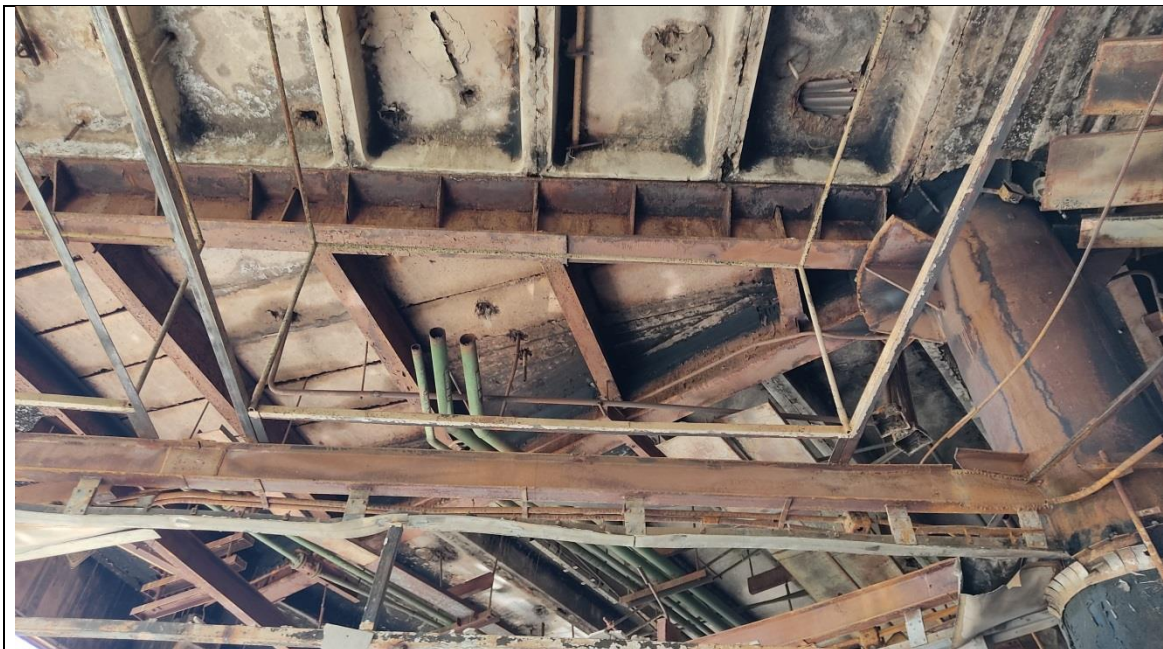
Фотография 29 – Повреждение металлических балок перекрытия в результате термического воздействия на 3 этаже здания в осях А-Б/8-9
