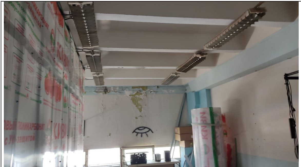
Фотография 7 – Общий вид не поврежденного термическим воздействием внутреннего помещения на техническом этаже здания в осях Б-В/1-2
