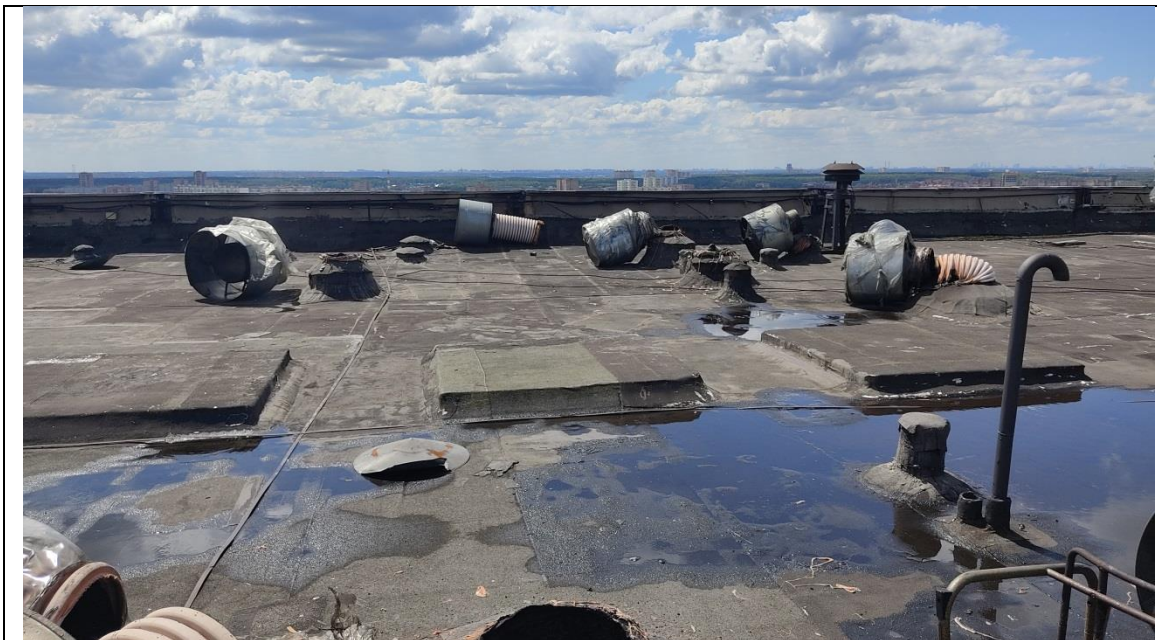
Фотография 5 – Повреждения вентиляционных вытяжек на кровле здания в результате пожара здания в осях А-Б/14-16
