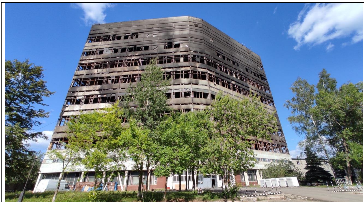
Фотография 1 – Общий вид поврежденного здания после пожара в осях А/1-16
