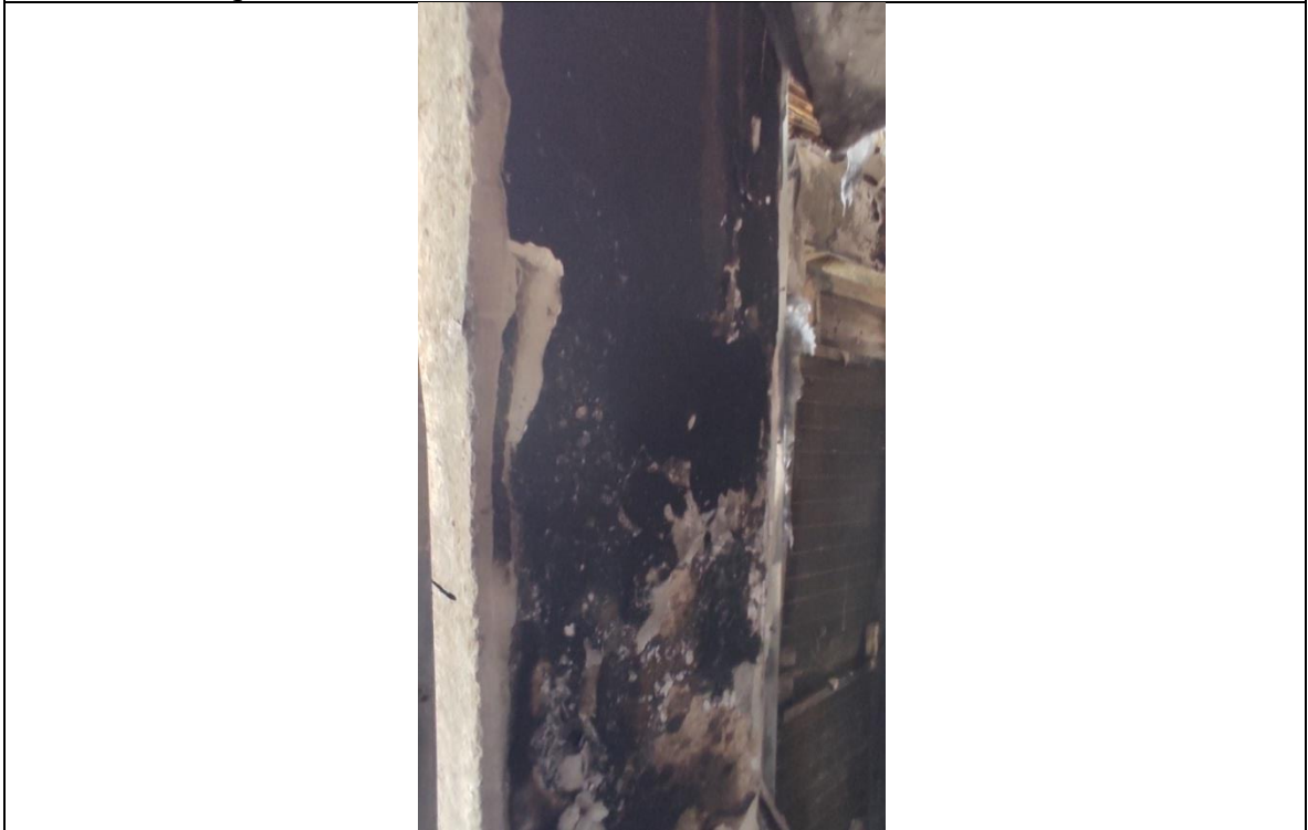
Фотография 18 – Повреждение защитного слоя бетона ж/б колонны в результате термического воздействия на 5 этаже здания в осях Б/4
