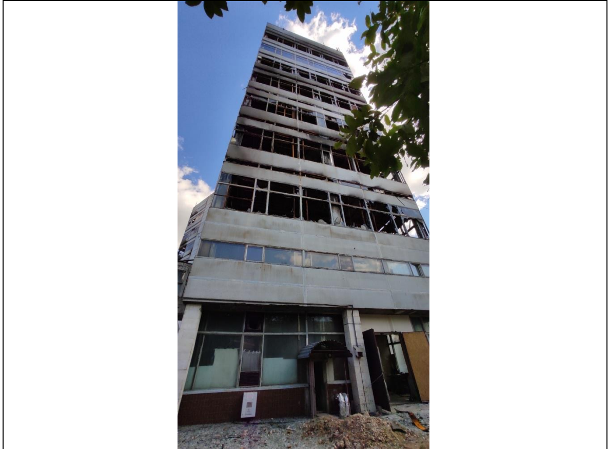
Фотография 3 – Общий вид поврежденного здания после пожара в осях А-В/1
