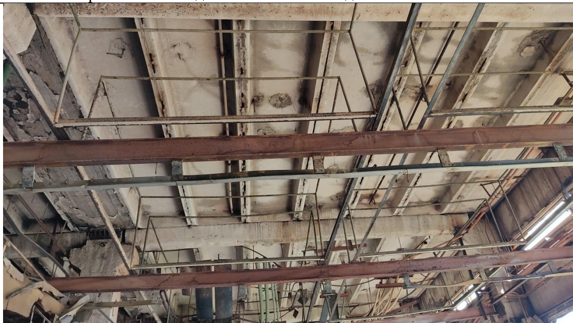
Фотография 28 – Разрушение межпанельных швов на плитах перекрытия 3 этажа здания в осях А-Б/4-5
