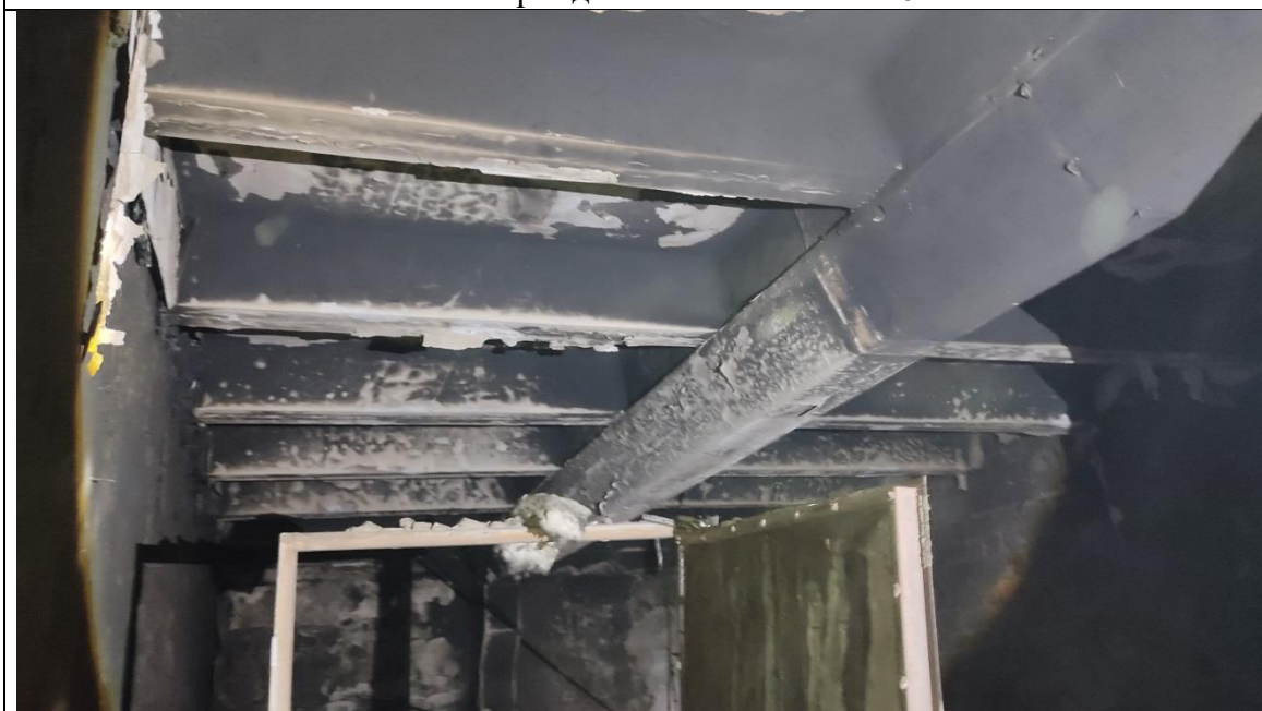
Фотография 6 – Повреждение ж/б плит покрытий и ж/б балок в результате термического воздействия на техническом этаже здания в осях А-Б/4-6
