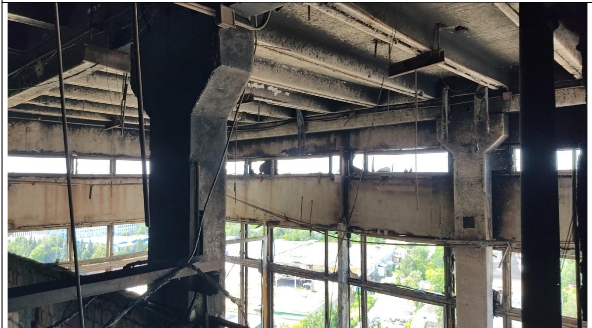
Фотография 8 – Повреждения ж/б плит перекрытий, колонн и балок в результате термического воздействия на 9 этаже здания в осях А-Б/1-2
