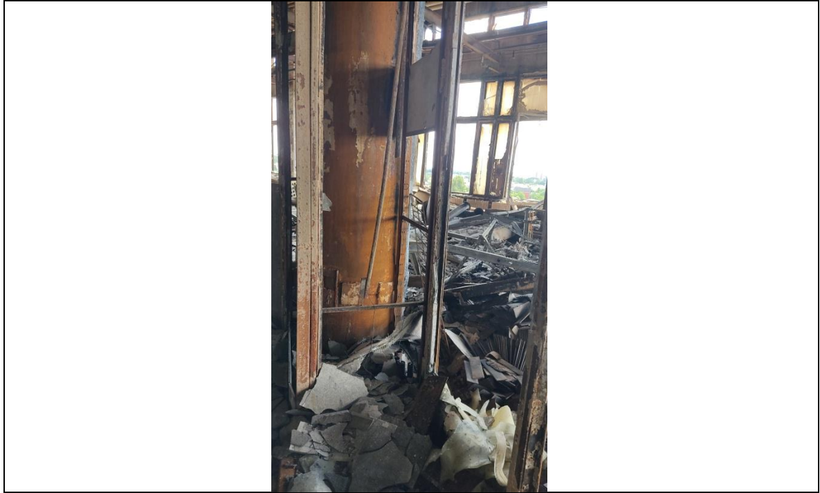
Фотография 23 – Повреждение металлической колонны в результате термического воздействия на 4 этаже здания в осях Б/8-9
