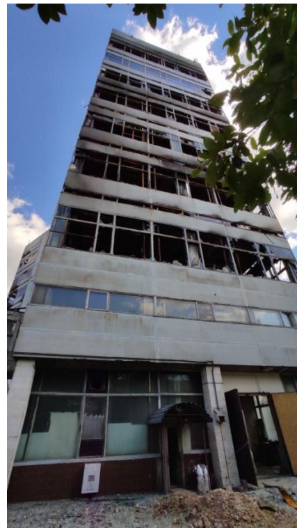
Фотография 1.3 – Общий вид поврежденного здания после пожара в осях А-В/1
