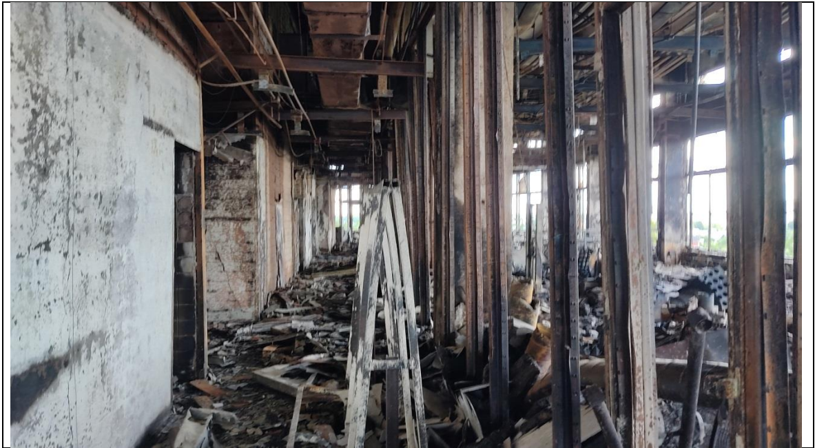
Фотография 21 – Общий вид повреждений внутренних конструкций в результате термического воздействия на 4 этаже здания в осях А-Б/1-2
