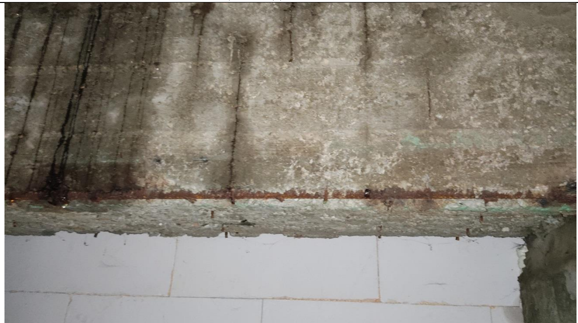
Фотография 34 – Оголение и коррозия арматуры на ж/б балке перекрытия подвального помещения здания в осях Б-В/2
