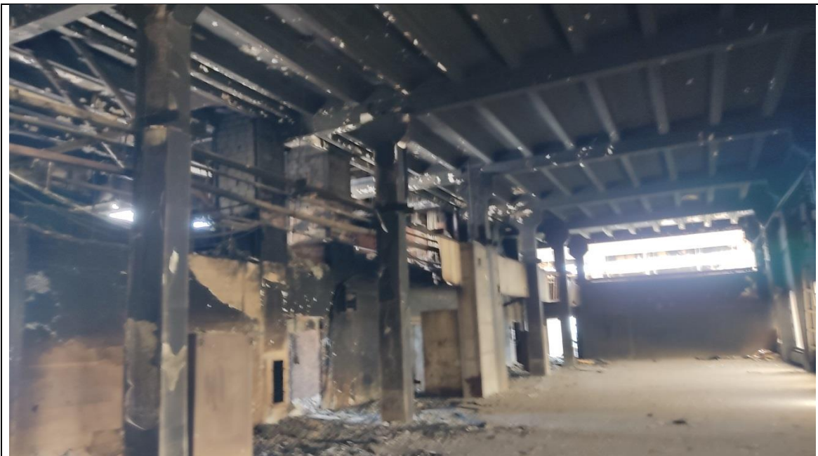
Фотография 11 – Повреждения ж/б плит перекрытий, колонн и балок в результате термического воздействия на 9 этаже здания в осях А-Б/10-16
