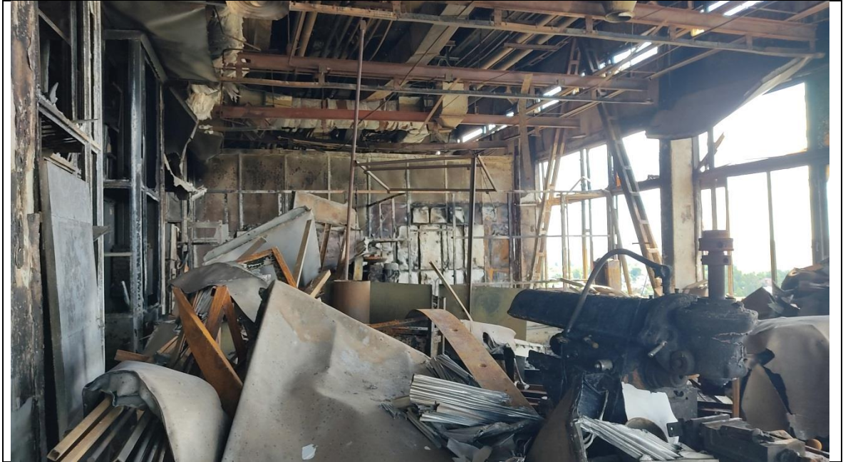
Фотография 15 – Общий вид поврежденных внутренних конструкций в результате термического воздействия на 6 этаже здания в осях А-Б/3-6
