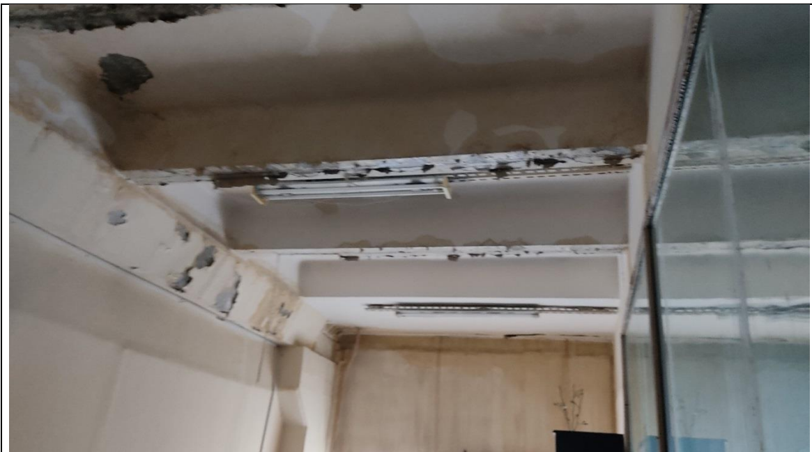
Фотография 31 – Намокание плит перекрытий в результате тушения пожара на 2 этаже здания в осях А-Б/2-3
