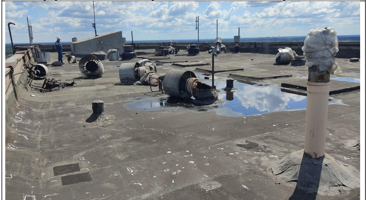
Фотография 4 – Повреждения вентиляционных вытяжек на кровле здания в результате пожара здания в осях А-В/11-14
