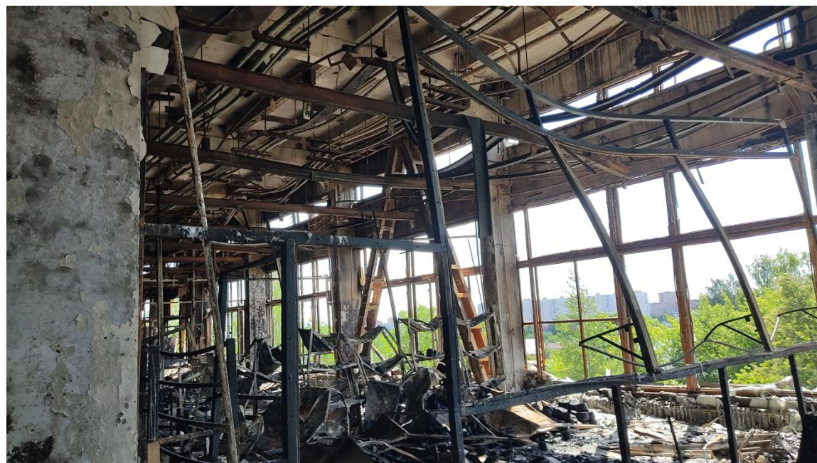
Фотография 26 – Общий вид поврежденных внутренних конструкций в результате термического воздействия на 3 этаже здания в осях А-Б/3-8
