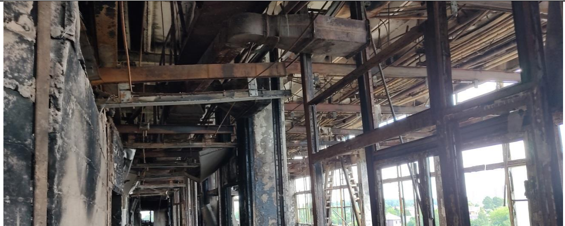
Фотография 24 – Общий вид повреждений внутренних конструкций в результате термического воздействия на 4 этаже здания в осях А-Б/10-14
