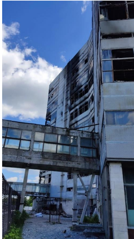
Фотография 1.2 – Общий вид поврежденного здания после пожара в осях В/1-16
