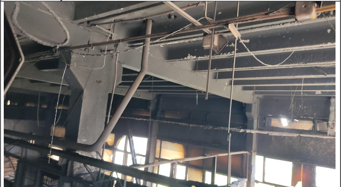
Фотография 10 – Повреждения ж/б плит перекрытий, колонн и балок в результате термического воздействия на 9 этаже здания в осях А-Б/3-4
