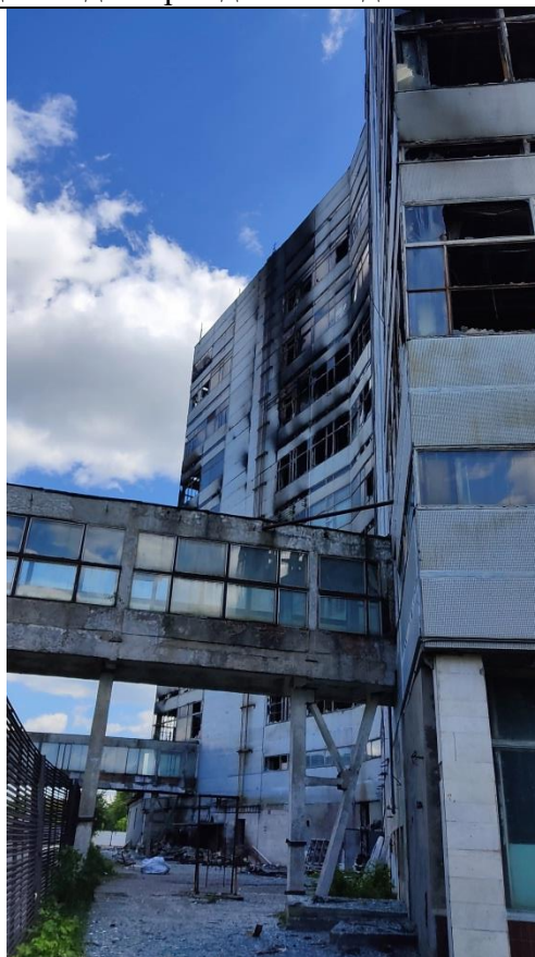
Фотография 2 – Общий вид поврежденного здания после пожара в осях В/1-16
