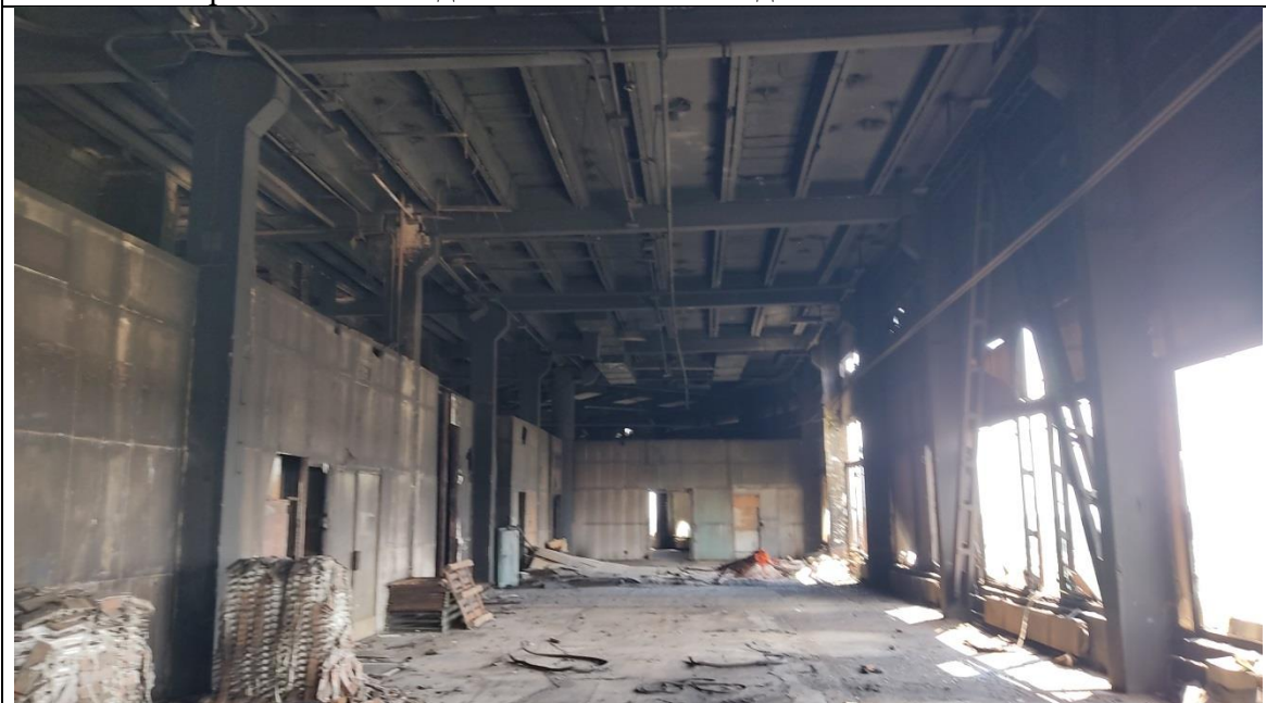
Фотография 12 – Повреждения ж/б плит перекрытий, колонн и балок в результате термического воздействия на 8 этаже здания в осях А-Б/2-7
