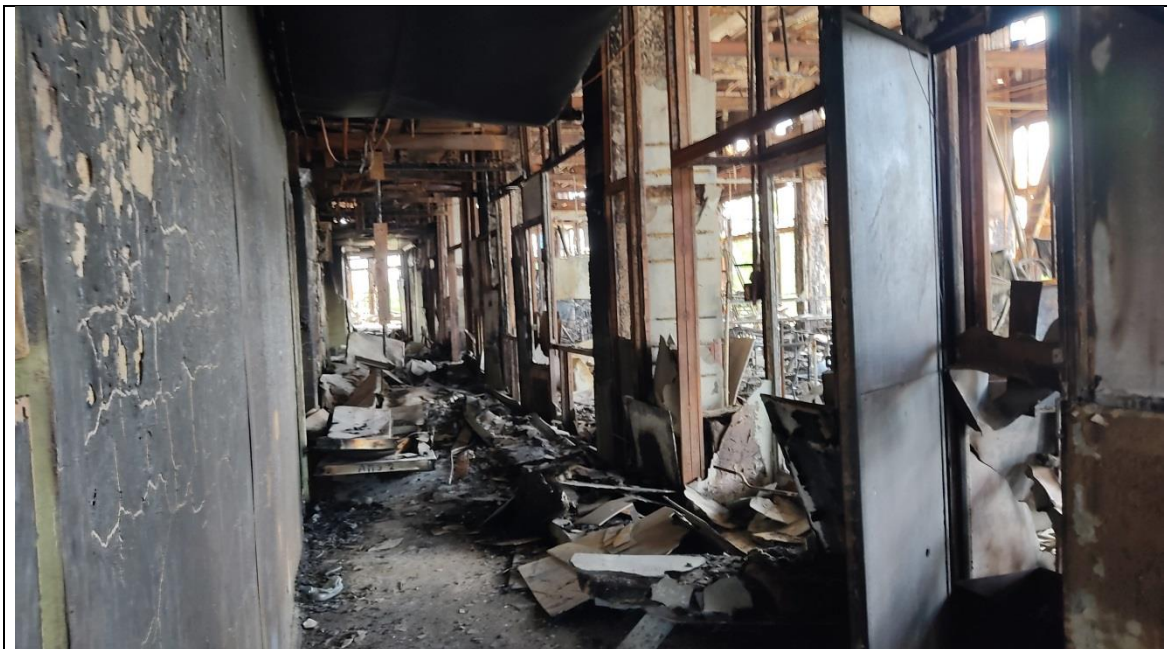
Фотография 25 – Общий вид поврежденных внутренних конструкций в результате термического воздействия на 3 этаже здания в осях А-Б/3-8
