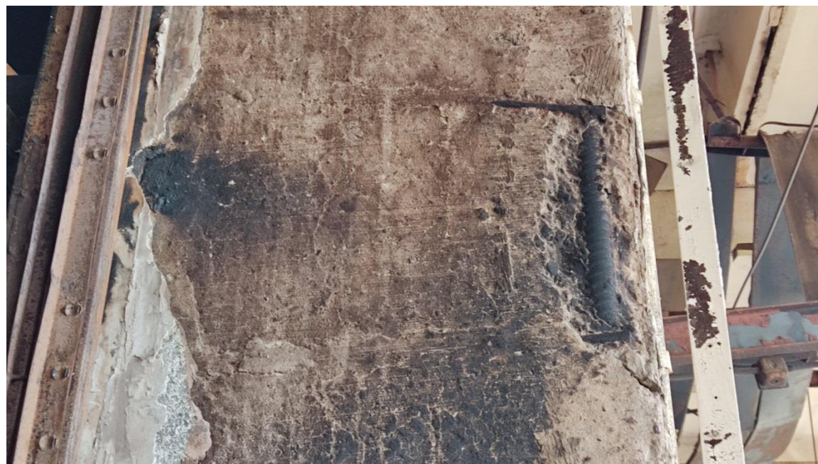
Фотография 30 – Разрушение защитного слоя бетона, оголение арматуры в колонне на 3 этаже здания в осях Б/7
