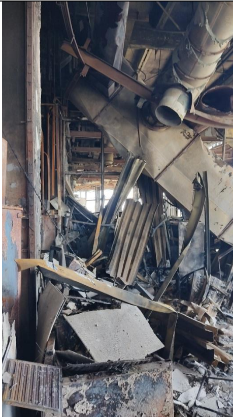
Фотография 14 – Общий вид повреждений внутренних конструкций в результате термического воздействия на 7 этаже здания в осях А-Б/3-6
