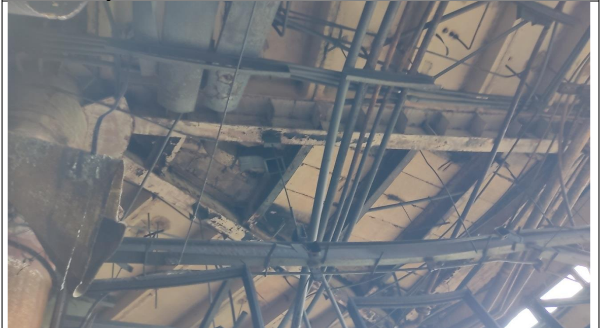
Фотография 16 – Общий вид поврежденных внутренних металлических конструкций в результате термического воздействия на 6 этаже здания в осях А-Б/8-9
